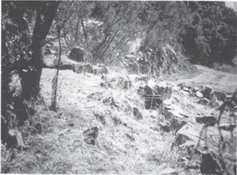
Figura 1. Se aprecia a la derecha de la fotografía el tramo del camino vehicular que abrió un boquete destruyendo 4,5 m del muro 2.
