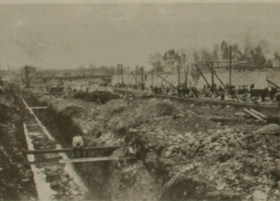
Las gruesas fundaciones que socavaron el puente de Calicanto.
